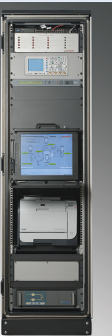
Bild 1: Realisierungsbeispiel einer Online-Schwingungsüberwachung in einem Kraftwerk
